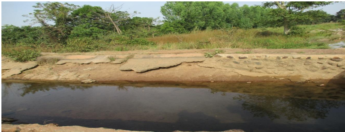
Canal primaire dégradé
